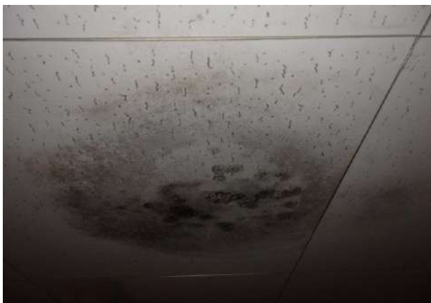
施工前：ジプトーンに繁殖したカビ
