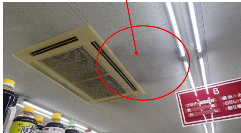
天井埋め込み式エアコンの吹き出し口周辺の黒ズミ
